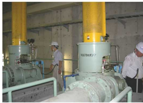
じょうか 浄化センターにある「ポンプ」 おすいかん 汚水管で集まってきた汚水を 地上にある池にくみあげています。
