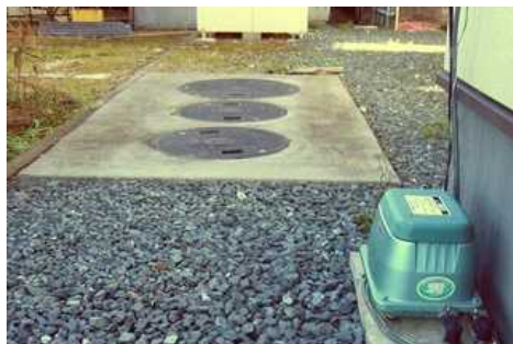
じょうかそう 浄化槽とブローア じょうかそう 浄化槽は地下にあるので、見える のは、フタだけです。近くには、 ブローアとよばれるび生物に空気を 送る機械があります。
